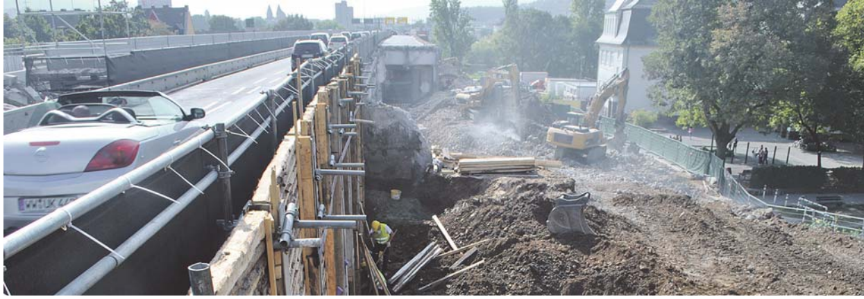
September 2014: Die rechte Fahrbahn der B 9 Richtung Boppard fehlt.
