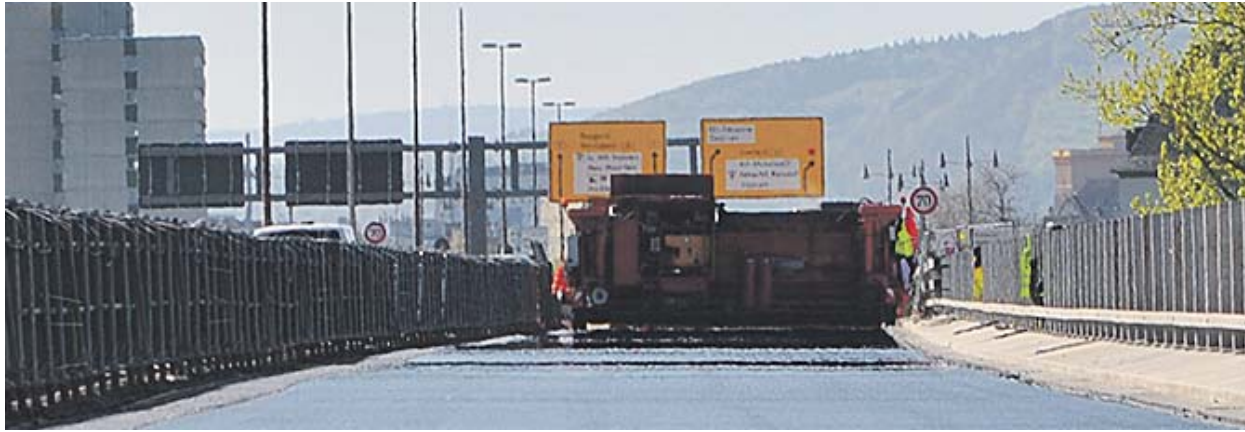
April 2016: Die neue Brücke steht und die rechte Fahrbahn erhält ihre Asphaltdecke.
